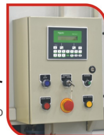
Painel de comando
